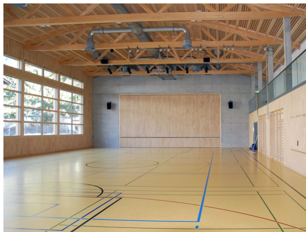
Suffisamment de place pour les tuyaux de ventilation grâce à la construction en treillis
